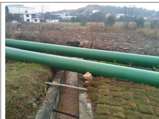
碳酸钙车间东面集水井
