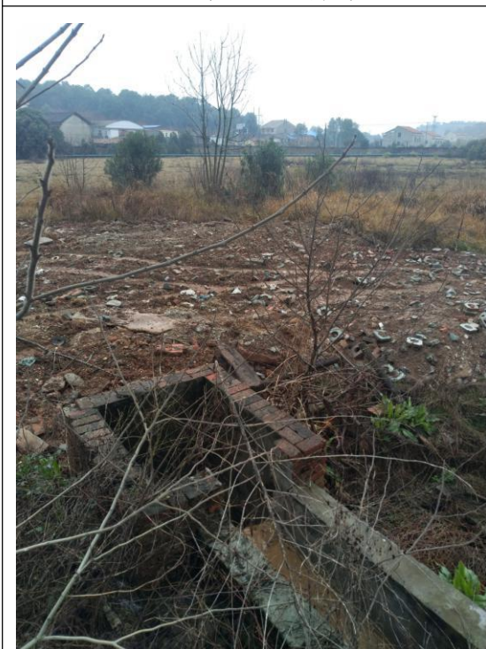
碳酸钙车间东面集水井
