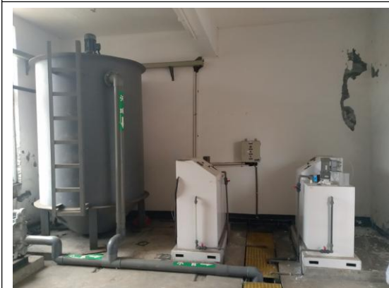
污水处理站设备间
