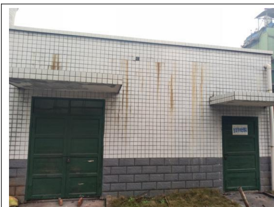
厂区生活污水处理站
