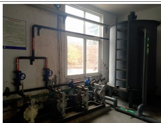
污水处理站设备间
