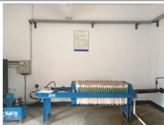
污水处理站设备间
